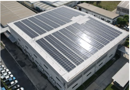
再生可能エネルギー導入の例 (タイ工場 太陽光発電システム)
